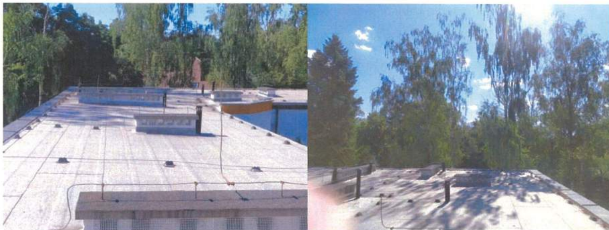
Rysunek 13 Dokumentacja fotograficzna zacinienia dachu budynku DPS
