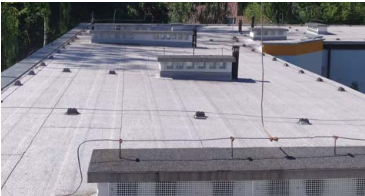
Rysunek 4 Zdjęcie pokrycia dachowego i istniejącej instalacji odgromowej
